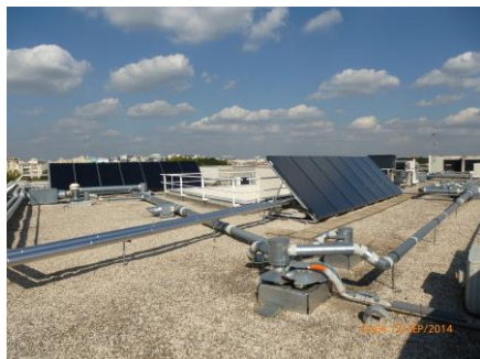
Installation solaire thermique en toit-terrasse
