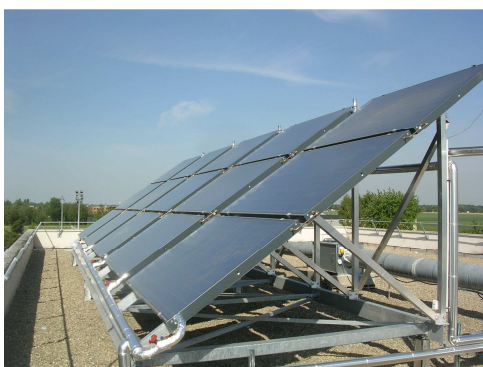
Capteurs solaires du toit de la Résidence 1 du CESAL
