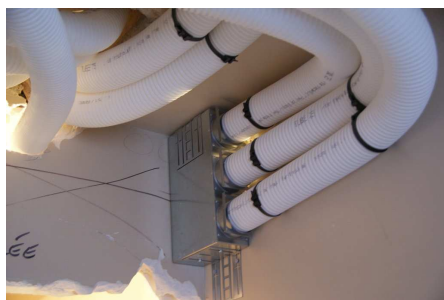
Gainés de ventilation
